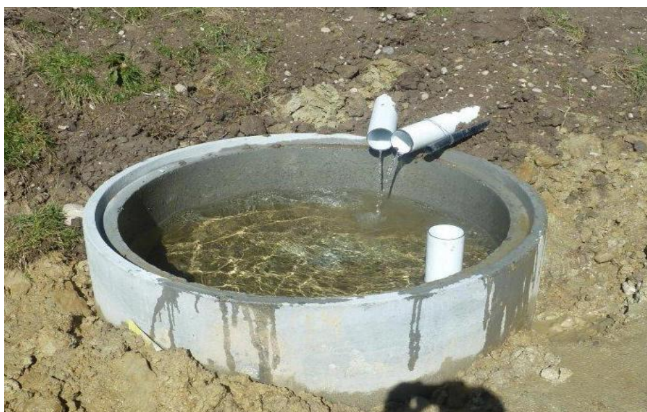
Die neue Wasserfassung für Haus und Scheune.
