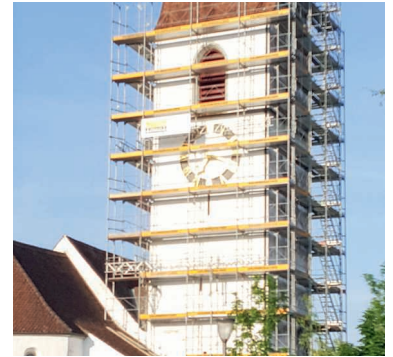
In Bertiswil stehen Reparaturen an.
